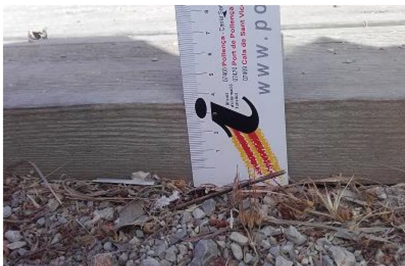
Escaló en els ponts que dificulta l'accés en cadira de rodes.
